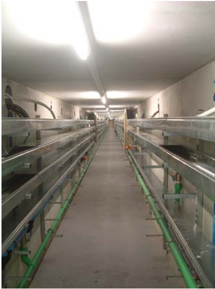
Fig.10.Vista de los túneles de servicios
